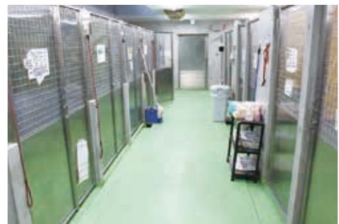
犬の収容室は全て個室で、地中熱を利用した床暖房を備えています。
